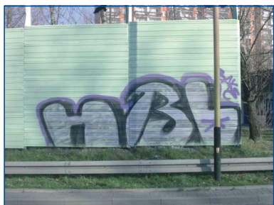
graffiti na zabezpieczonym ekranie akustycznym
